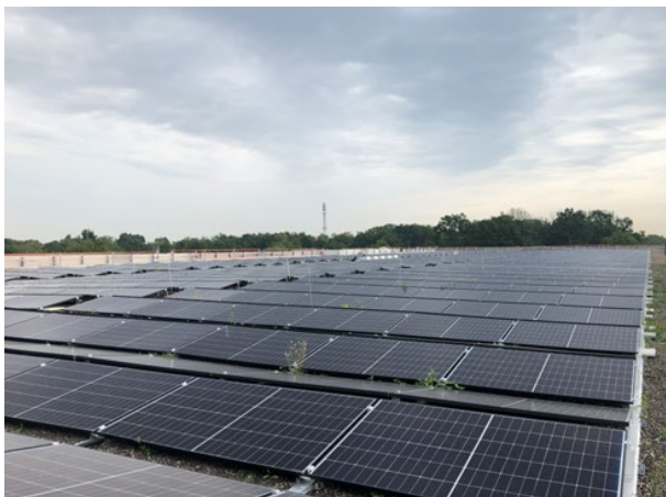
Toiture avec Photovoltaïque (Photo: AMP)
